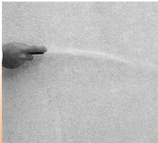
Humedecer el mortero del revestimiento con agua pulverizada al final de la jornada. No humedecer a pleno sol o con el revestimiento sobrecalentado
