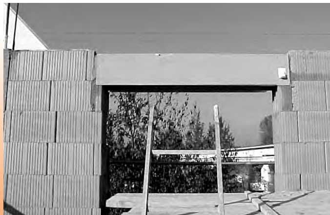
Apoyo insuficiente del cargadero
