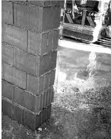
Jamba ejecutada correctamente, pues la separación entre juntas verticales de hiladas consecutivas es mayor de 7 cm
