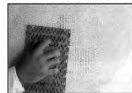
La malla se balla demasiado cerca de la superficie. Es ineficaz y puede aflorar durante la ejecución del acabado
