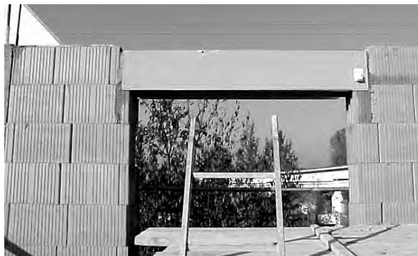
Jamba mal ejecutada, pues no hay suficiente separación entre las juntas verticales de hiladas consecutivas
