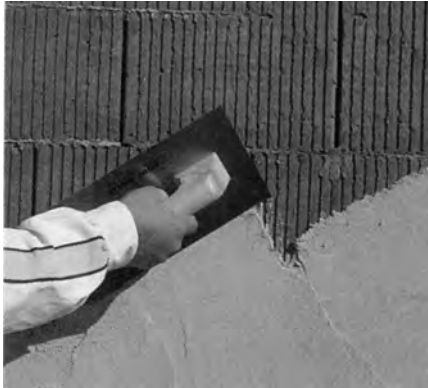
La aplicación del mortero monocapa sobre bloque Termoarcilla se puede realizar de forma manual...
