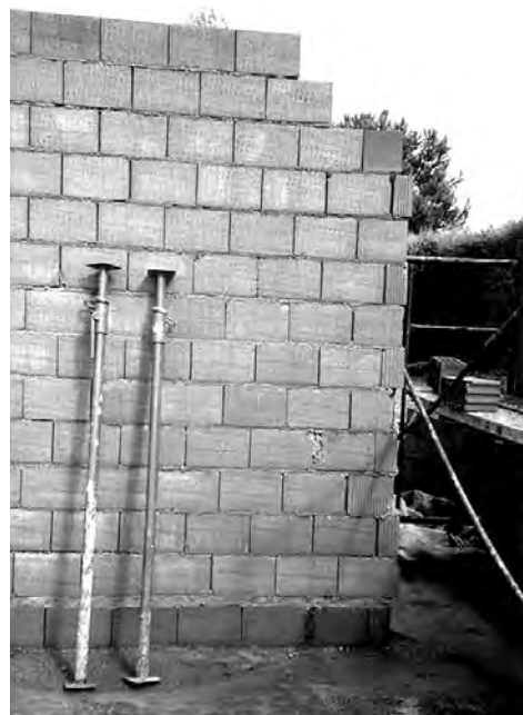
Jamba ejecutada incorrectamente pues no tiene verticalidad
