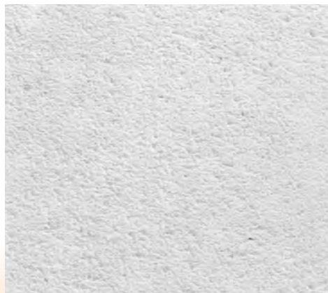
Efecto de un detalle de fachada revestido con un mortero monocapa.
